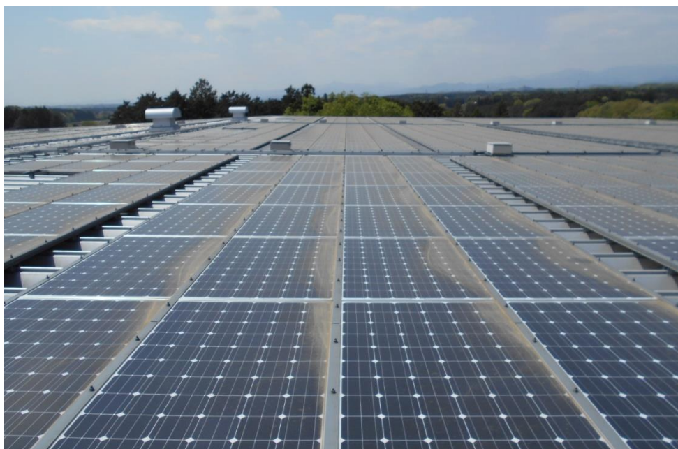
汚れたパネル
